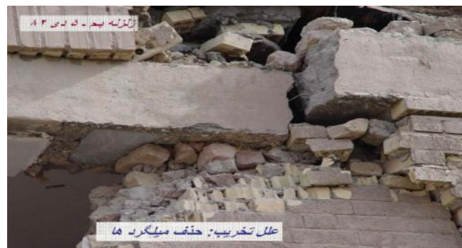
شکل ۱: پیامد های ناشی از اثر معضلات اجرایی در زلزله بم.
