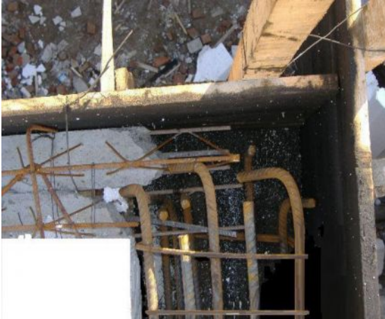
شکل ۱۲- اجرای غیر اصولی تیرچه به تیر کنسول.
