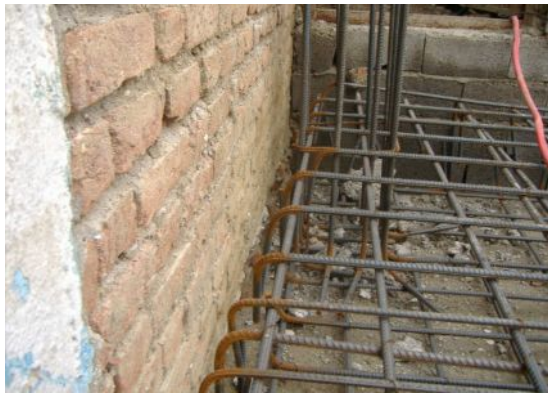
شکل ۶- ادامه ندادن خاموت ستون در داخل فنداسیون.
